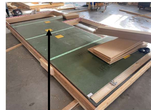
Scotch qui bouche les trous nécessaires au souffleur de ouate de cellulose
