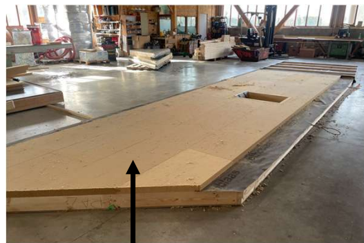
Membrane + un panneau en fibre de bois pare-pluie (côté extérieur à enduire)
